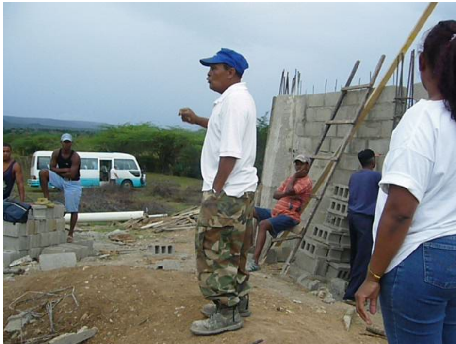
Vattentank, Hacienda Paso Robles
